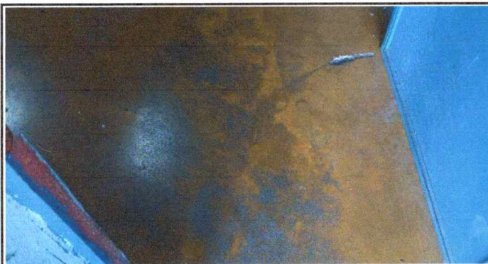
Foto 3: Mejoramiento de piso amarillo de la oficina y archivo de la dirección en mal estado por piso cerámico
